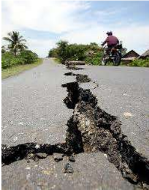
Mal estado de las carreteras
