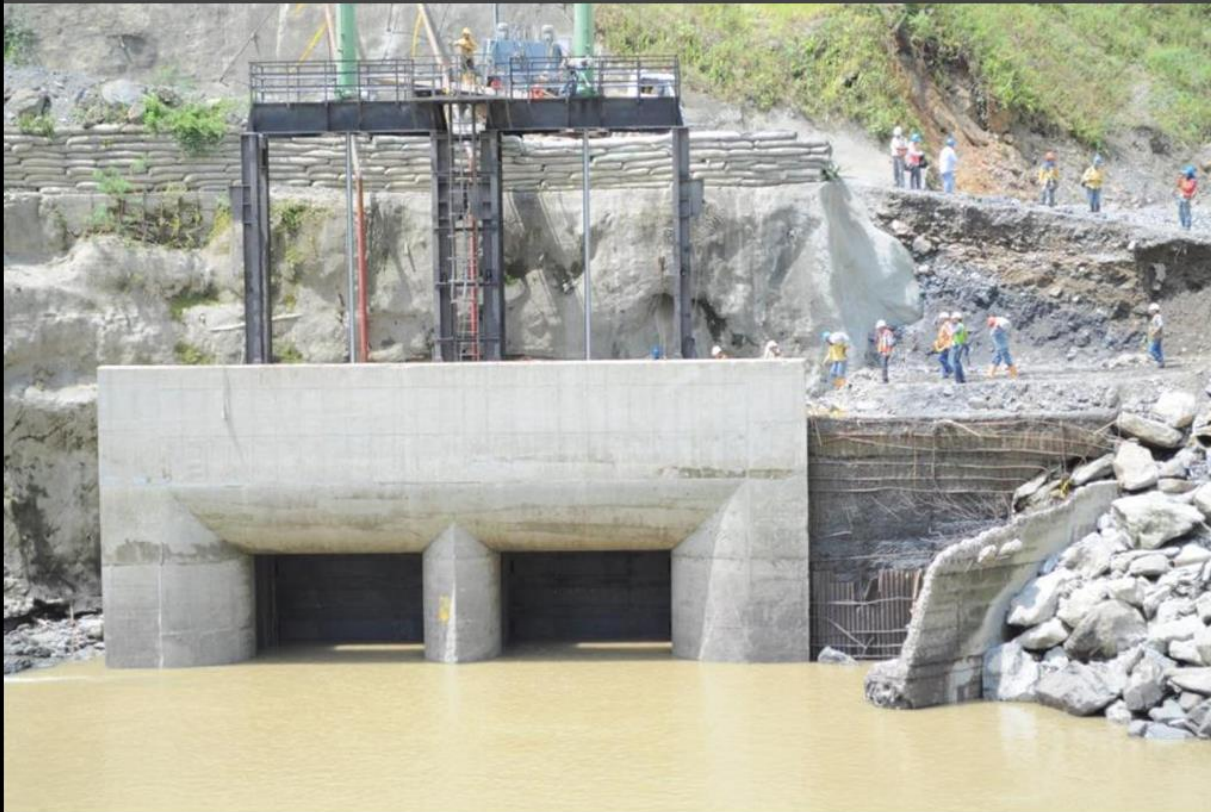
En pocos minutos el agua cubrió el túnel de desviación...
